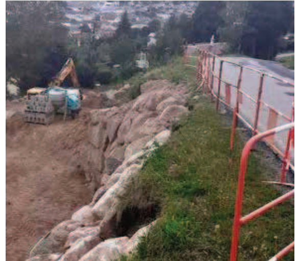
Des prescriptions inapplicables étant donnée la déclivité du terrain
